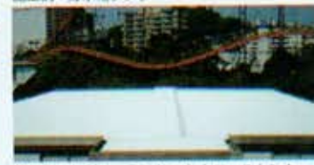
施工例：レジャーランドコントロールセンター
